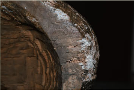
(修復前) 石膏の劣化
